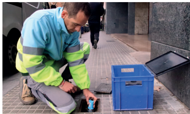
Un operari d'aigües de Manresa comprova un dels sensors que s'han instal·lat al Passeig Pere II. Foto: ACN
