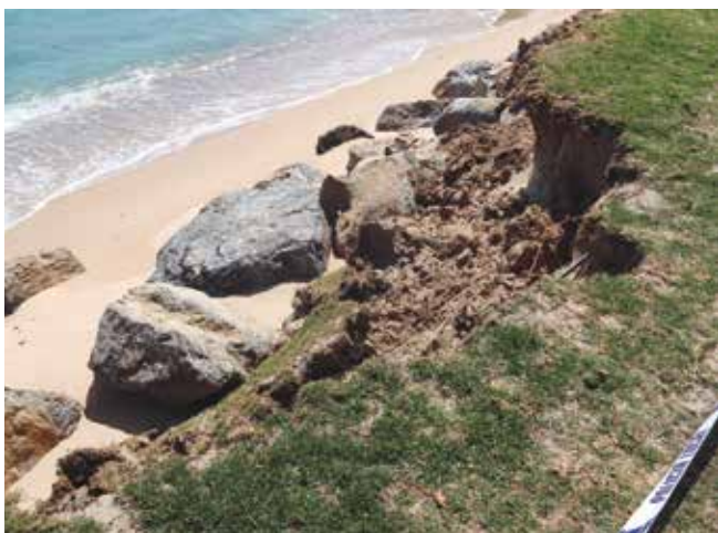
Un tros del passeig marítim de Torre Valentina esfondrat arran dels últims temporals.
