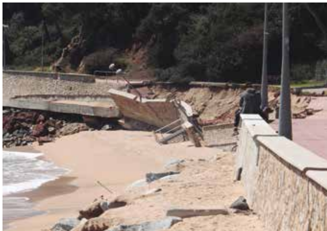
El passeig de Fenals de Lloret de Mar destrossat per una grabinada.
