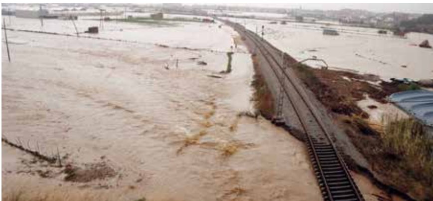
Imatge de les vies del tren destrossades entre Malgrat i Blanes pel pas de la Tordera, que s'ha desbordat 22 de gener del 2020. Foto: Eduard Batlles
