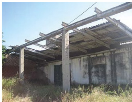
Cubierta de fibrocemento visiblemente deteriorada. Fuente: Sección de Prevención de Riesgos Laborales. ISPLN.
